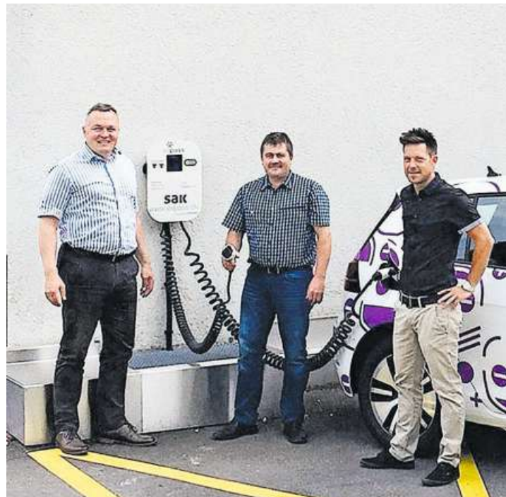
Freuen sich über die neu installierte Ladestation: (von links) Kilian Looser, Gemeindepräsident, Heimo Brülisauer, Brauerei Schützengarten AG, und Marco Hobi, Verkaufsberater E-Mobilität SAK. Bild: PD
